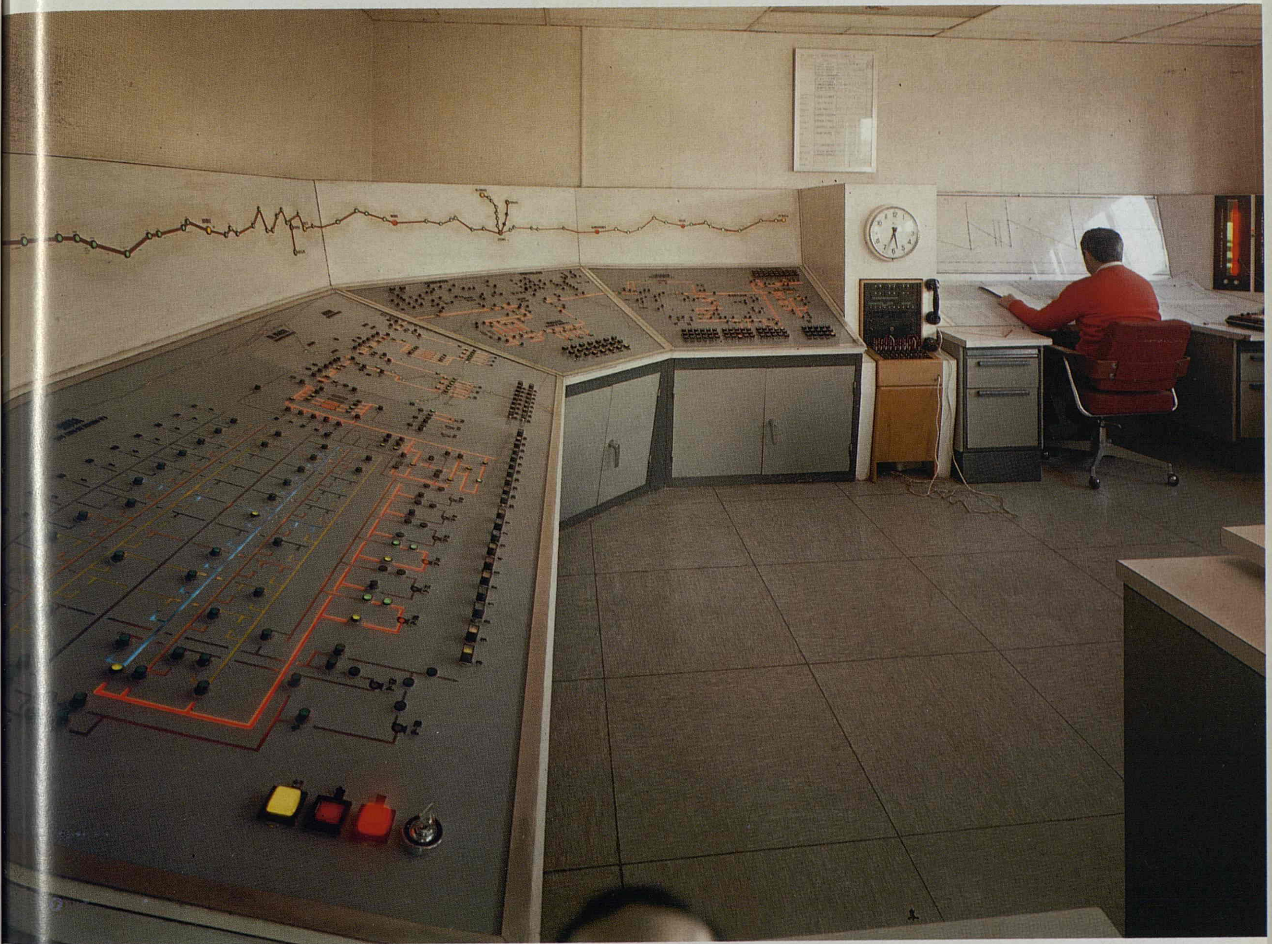
Sala de control de seguimiento de oleoducto
