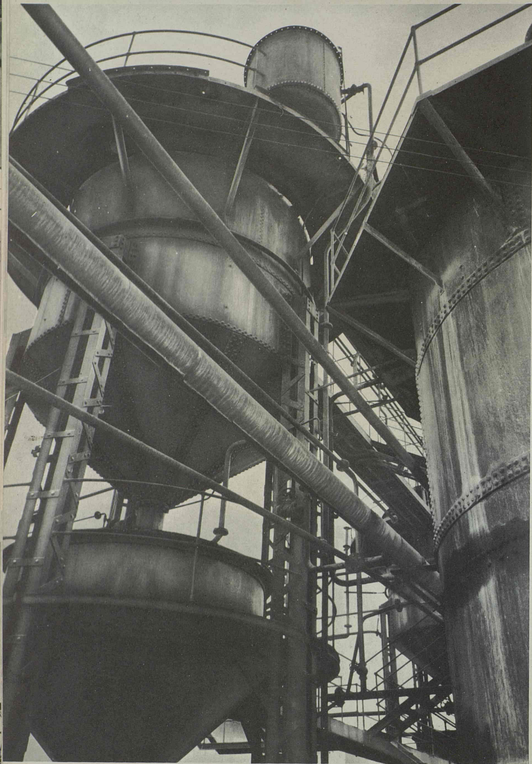
Instalación de refino químico. Cornellá (Barcelona)
