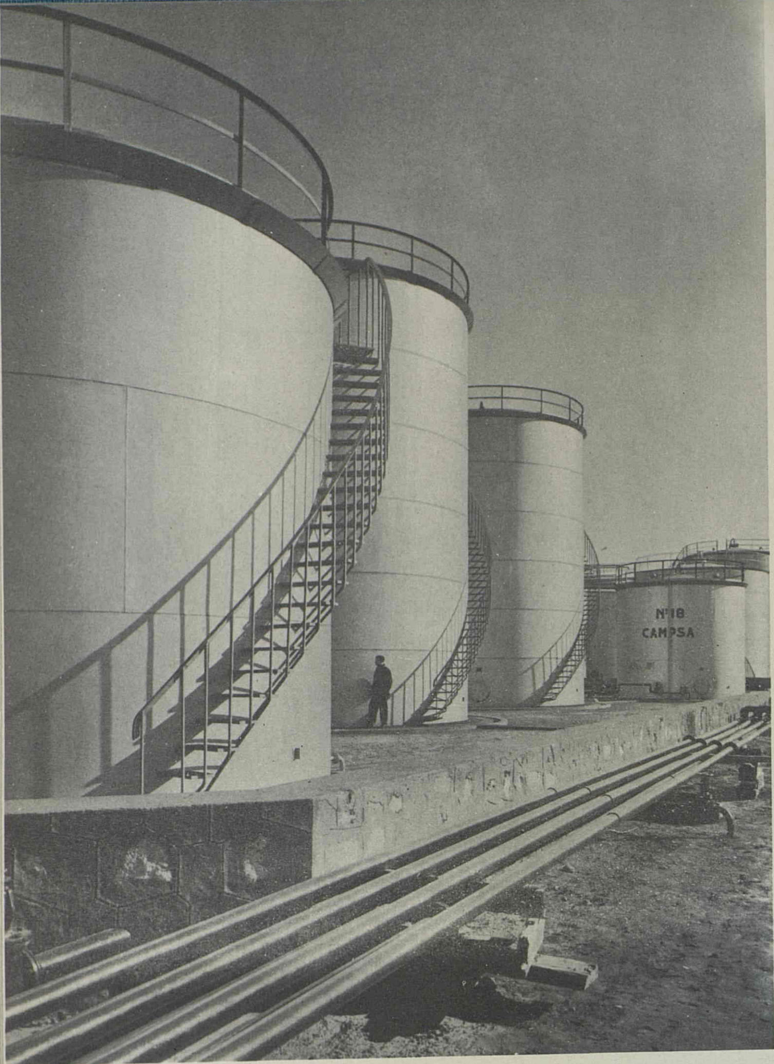
Cubeto de tanques en Almería...
