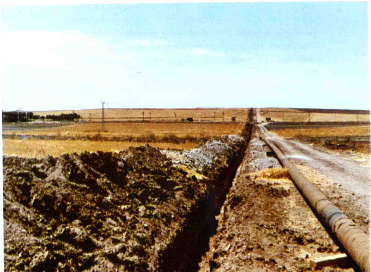
Oleoducto, tramo carretera de Valencia.
