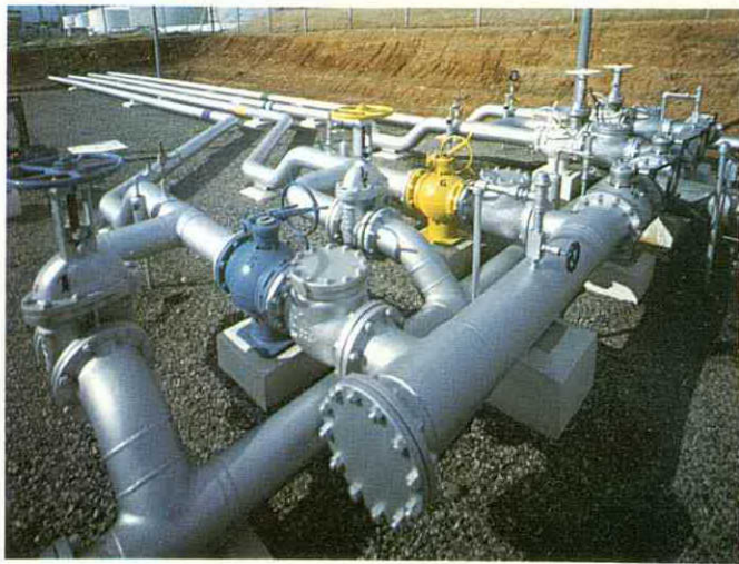
Cabecera de oleoducto. Puertollano.
