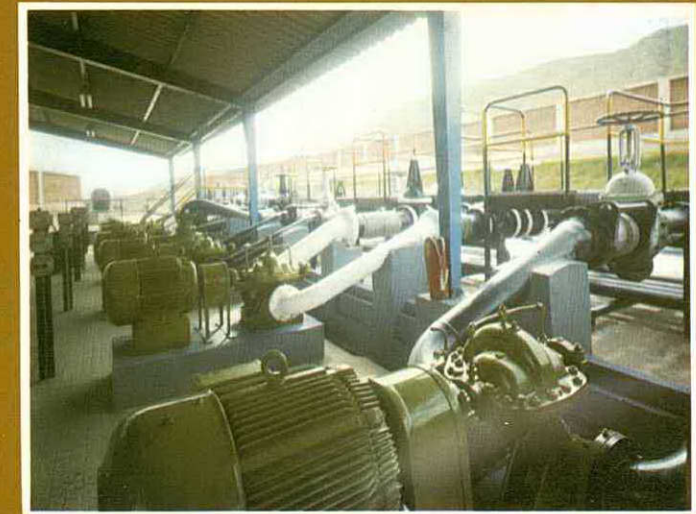
Instalación de descarga de vagones-cisterna en la Subsidiaria de Recajo (Logroño).
