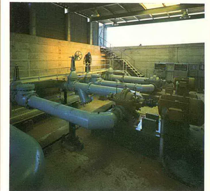
Sala de bombas de la Factoría de Torrejón de Ardoz.
