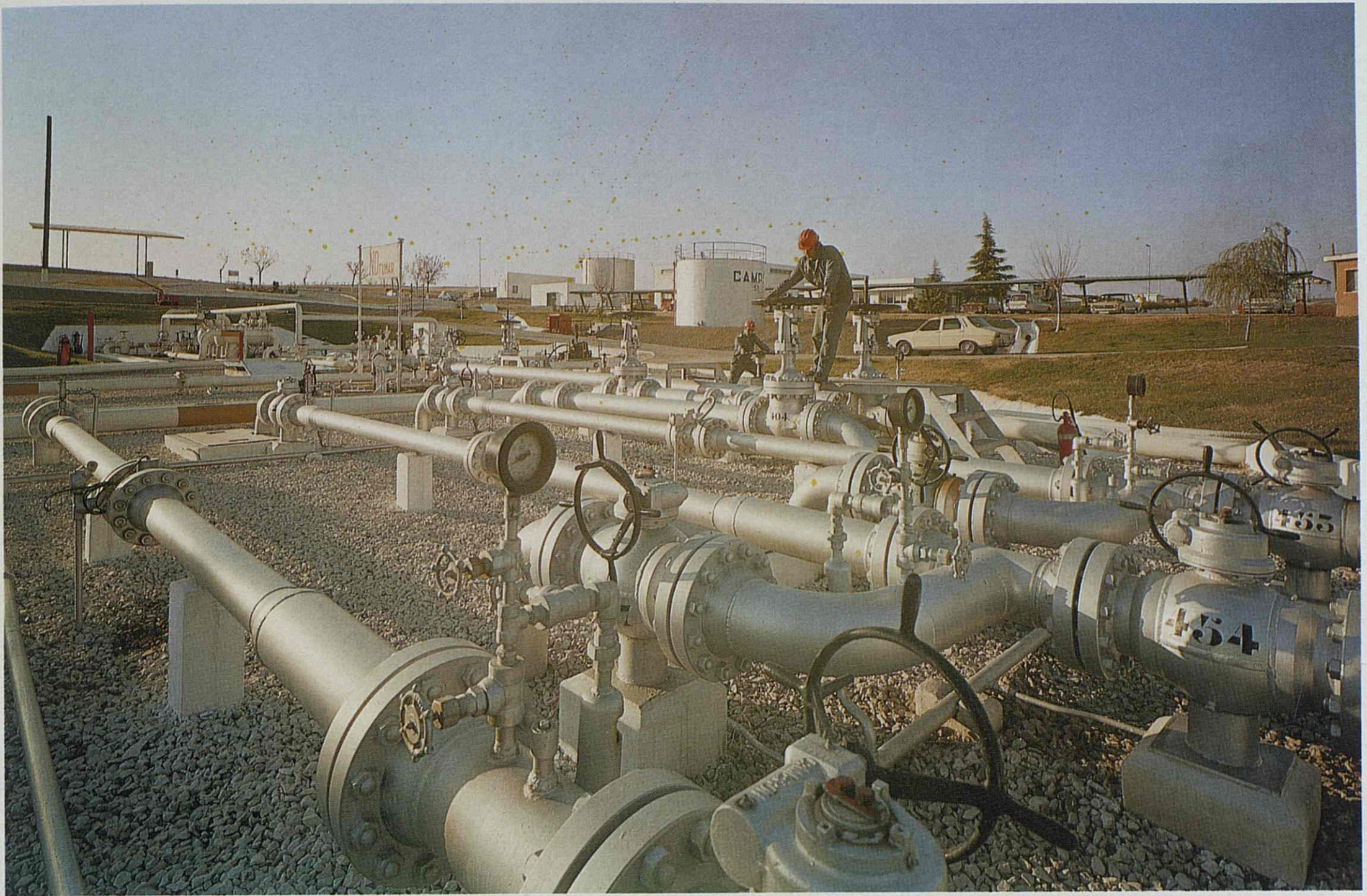
Estación de bombeo de Loeches
