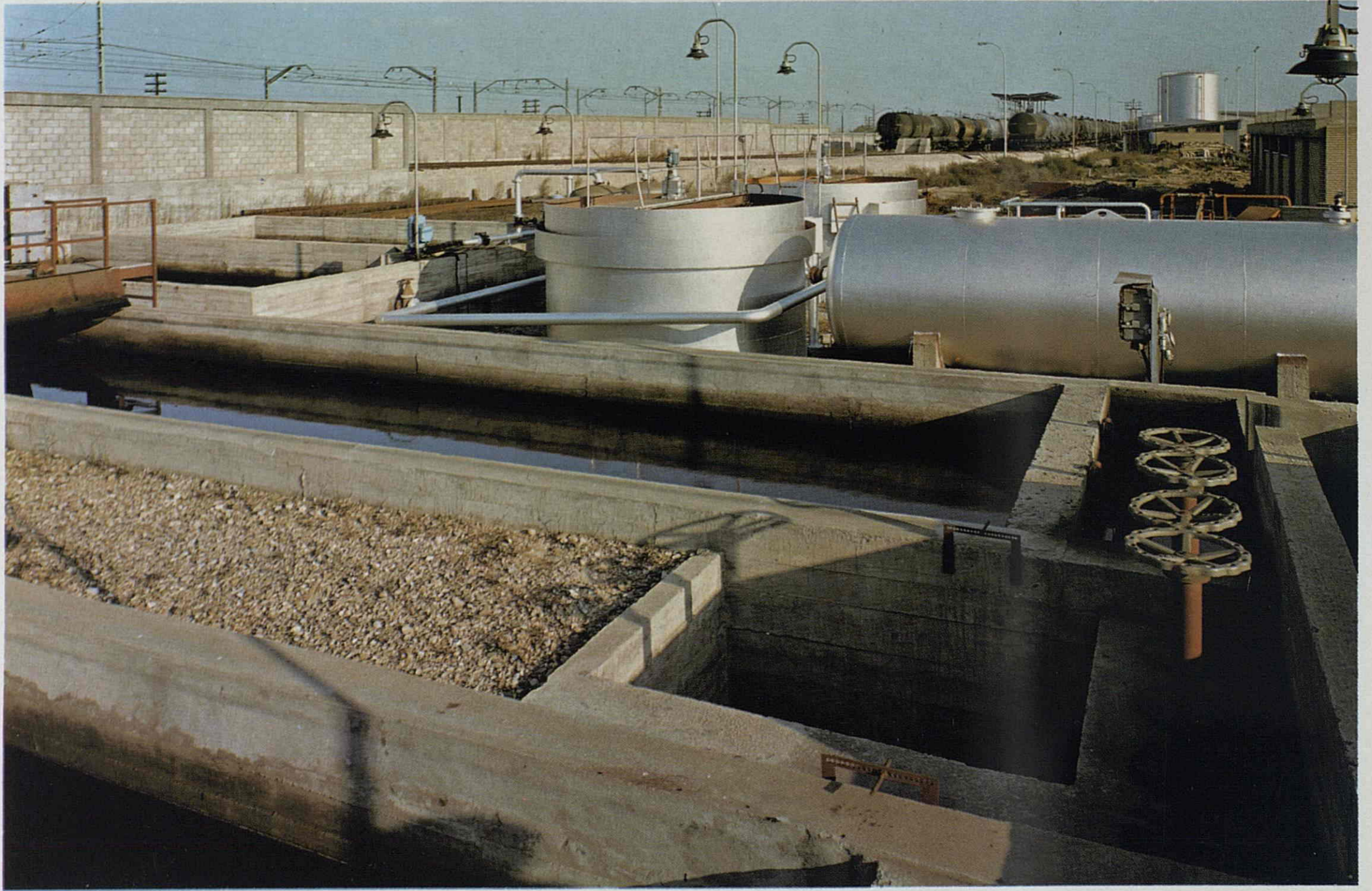
Depuradora de aguas residuales
